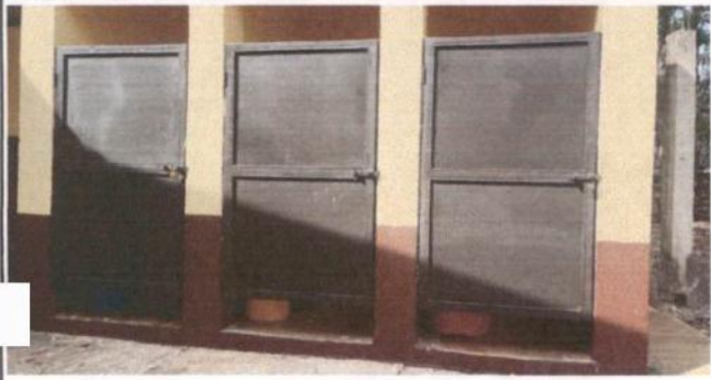
2. PUERTAS DE METAL 2.1 MANTENIMIENTO A ESTRUCTURA (LIJADO, CEPILLADO Y APLICACION DE PINTURA)
