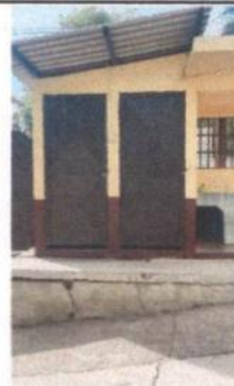
2. PUERTAS DE METAL 2.1 MANTENIMIENTO A ESTRUCTURA (LIJADO, CEPILLADO Y APLICACION DE PINTURA)
