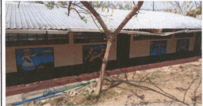
6. CANALES Y BAJADAS DE AGUA PLUVIAL 6.1 REPARACION DE BAJADA DE AGUA PLUVIAL
