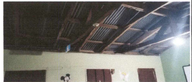
Foto 6: Madera y lámina en mal estado
