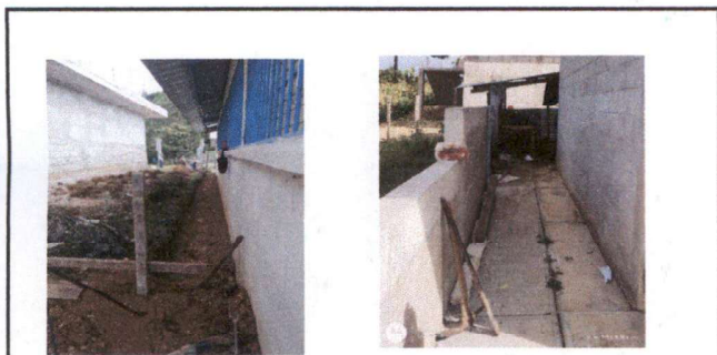
Foto 3: REPARACIÓN DE RED DE DRENAJES Y AGUA: REFORZAMIENTO DE FOSA SÉPTICA, SUSTITUCIÓN DE TUBERÍA PVC LINEA PRINCIPAL AGUAS NEGRAS (3 PULGADAS), RED DE AGUA ENTUBADA, (SUSTITUCIÓN DE TUBERÍA PVC LINEA PRINCIPAL Y SUS ACCESORIOS INSTALACIÓN INCLUIDA).
