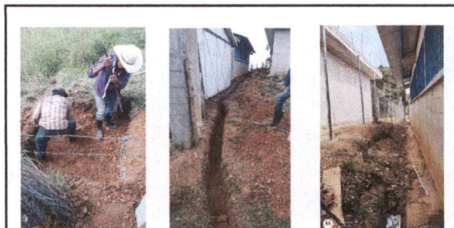
Foto 4: REPARACIÓN DE RED DE DRENAJES Y AGUA: REFORZAMIENTO DE FOSA SÉPTICA, SUSTITUCIÓN DE TUBERÍA PVC LINEA PRINCIPAL AGUAS NEGRAS (3 PULGADAS), RED DE AGUA ENTUBADA, (SUSTITUCIÓN DE TUBERÍA PVC LINEA PRINCIPAL Y SUS ACCESORIOS INSTALACIÓN INCLUIDA).
