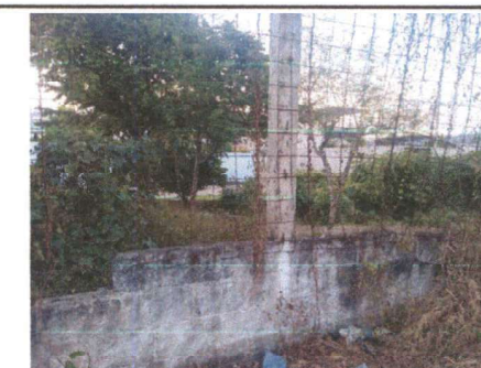
Foto 6: Muro en deterioro
