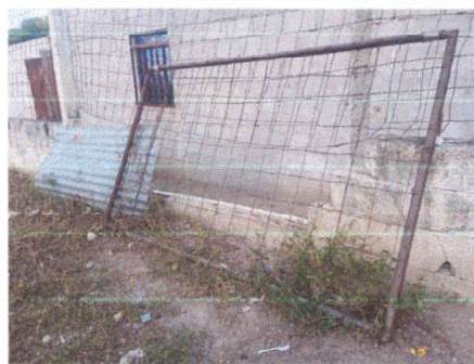
Foto 2: Muro derribado y tapado con laminas y puerta de metal
