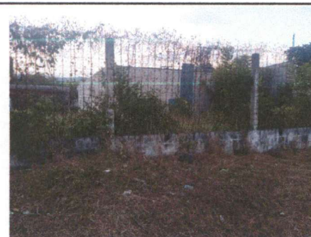
Foto 5: Muro en deterioro
