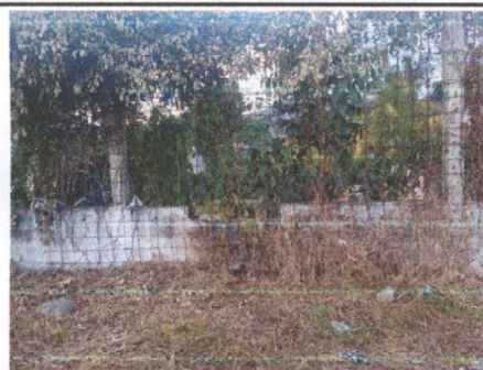
Foto 3: Muro deteriorado por el tiempo
