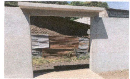
Foto 4: Pendiente instalación de portón
