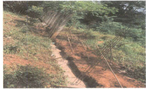
MURO EN MAL ESTADO
