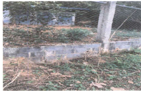
MURO EN MAL ESTADO
