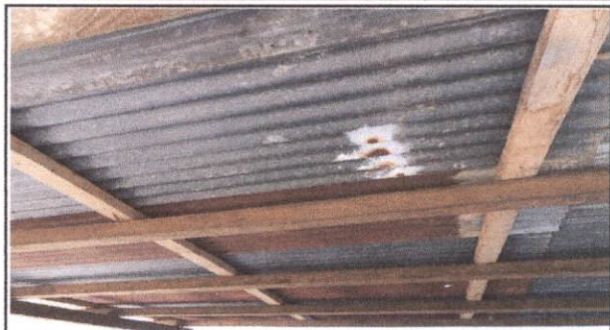
Foto 2: no se cuenta con estructura de metal en el techo.
