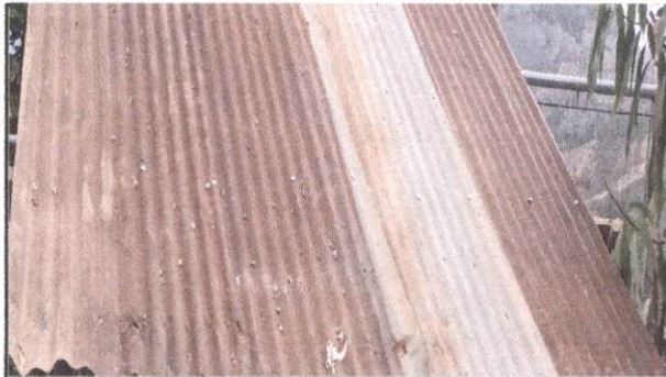
Foto 1: lamina de techo en los sanitarios en mal estado.
