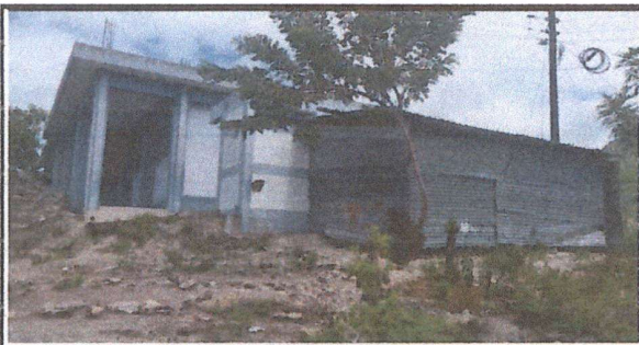
Foto 5: Salones posteriores con pintura en mal estado.
