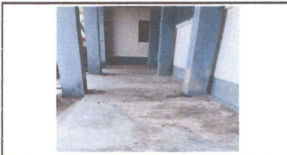
Foto 6: Torta de piso en mal estado que necesita mejora.
