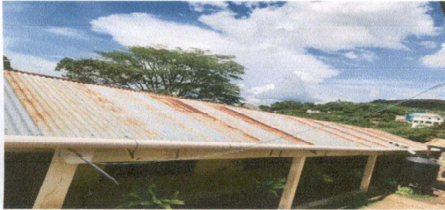
TECHO EN MAL ESTADO
