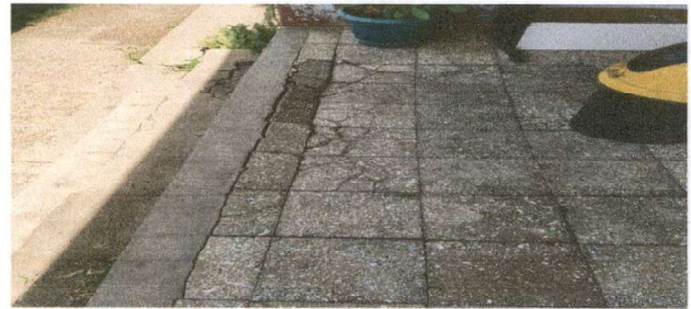
PISO EN MAL ESTADO
