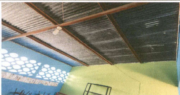
ESTRUCTURA METALICA EN MAL ESTADO
