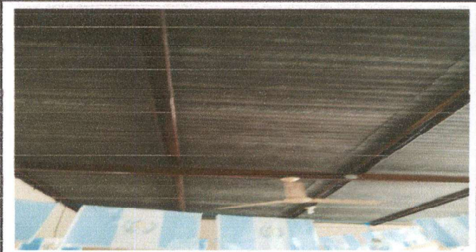
Foto 2: Techo en mal estado pasillo
