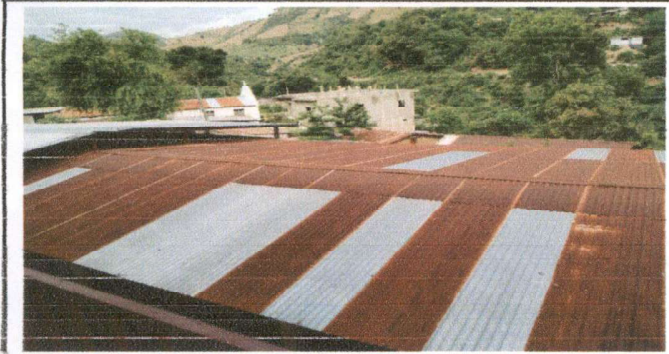
Foto 1: techo en mal estado
