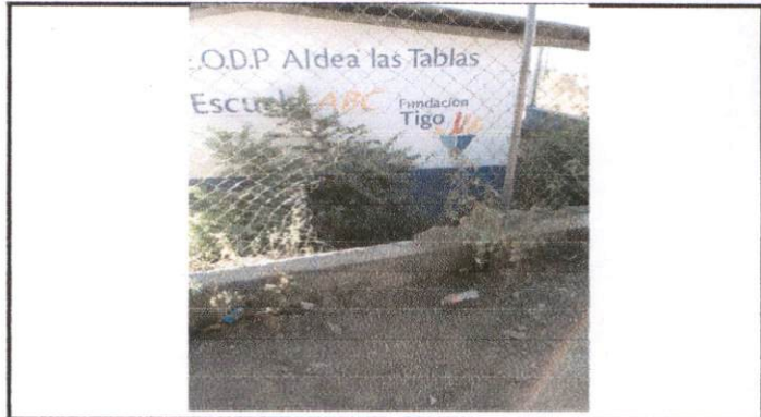
MALLA EN MAL ESTADO
