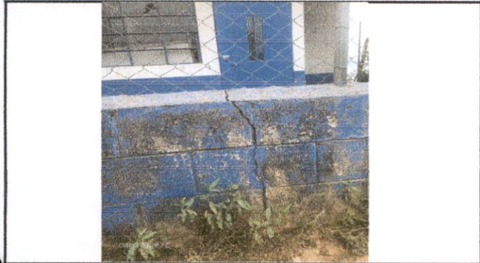
BASE DE MURO PERIMETRAL EN MAL ESTADO
