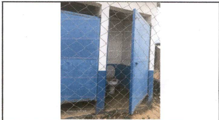
BAÑOS EN MAL ESTADO NECESITAN SER CAMBIADOS
