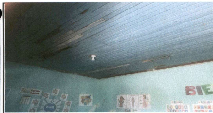
Foto 5: Deterioro del techo de sexto grado
