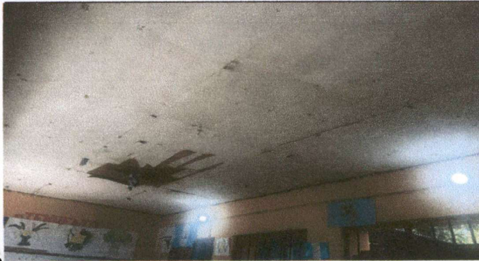
Foto 1: Deterioro del techo del grado de sexto grado Sección C
