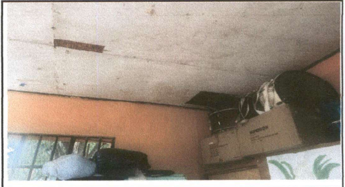
Foto 2: Deterioro del techo del aula de sexto grado.
