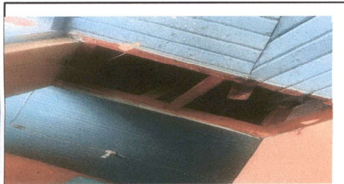
Foto 3: Deterioro de techo del aula de primero B
