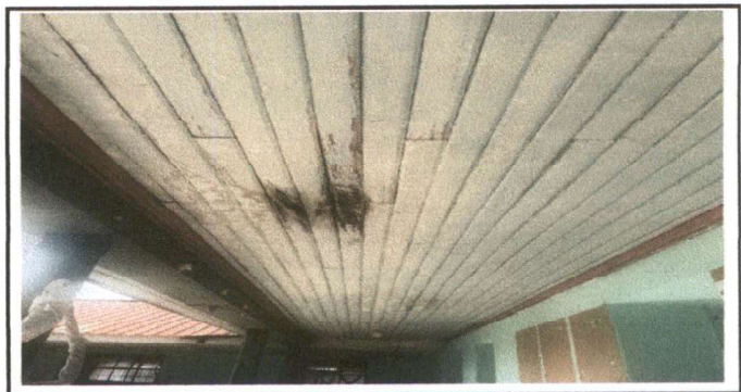
Foto 6: Deterioro del techo de corredores
