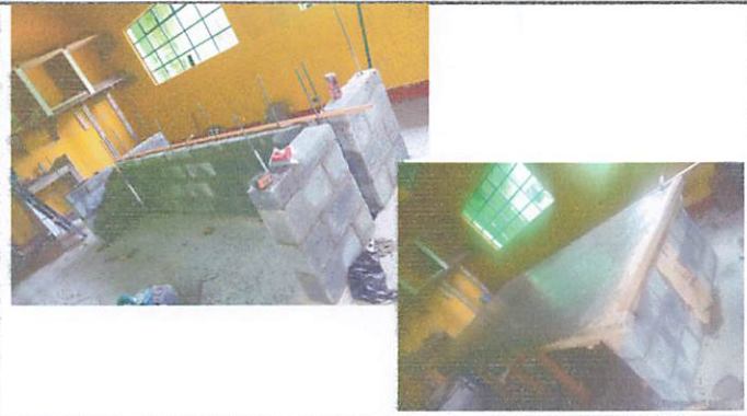
Foto 4: instalación de una isla en el centro para guardar cosas y que sirva de mesa.
