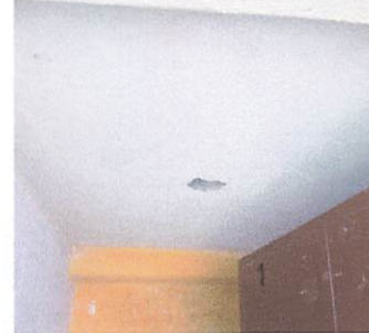
Foto 2: Los baños o sanitarios no cuentan con luz eléctrica-
