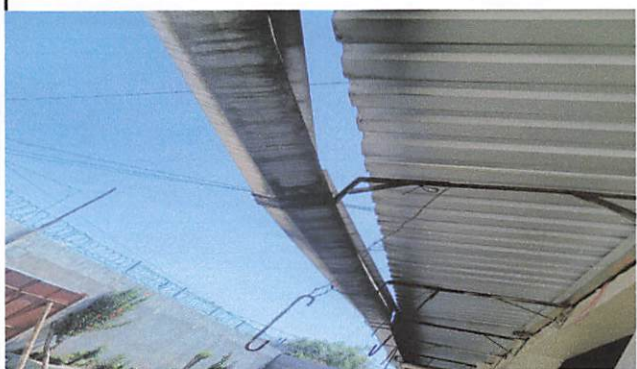
Foto 8: los canales estan deterriorados
