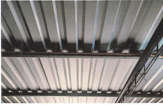
Foto 7.: El techo tiene un agujero y le cae agua,
