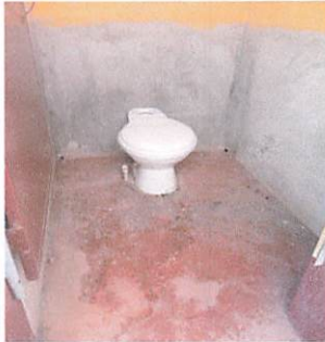
Foto1: Los baños inodoros no cuentan con su respectivo respectivo tamque de agua.
