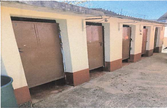
Foto 3: las puertas de los baños estan muy desterriorados.
