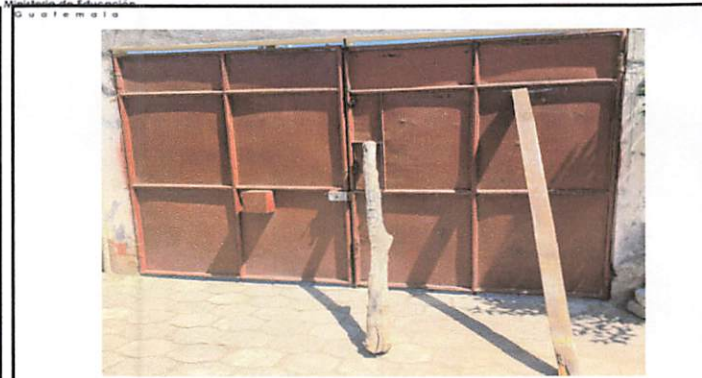
Foto 13: porton principal deteriorado y a punto de caer.
