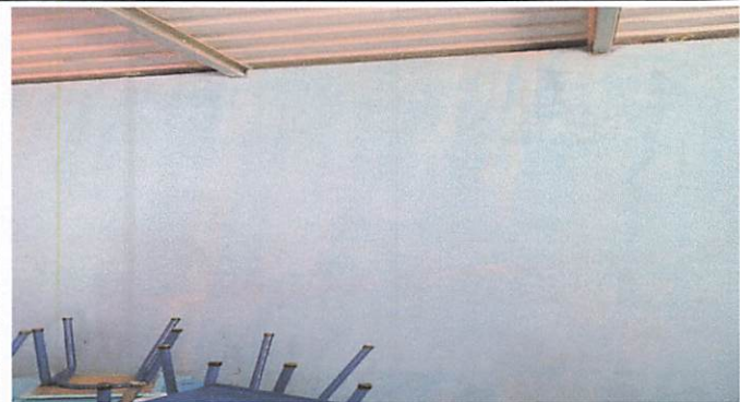
Foto 11.: Las paredes deterrioradas por la humedad y falta de pintura.
