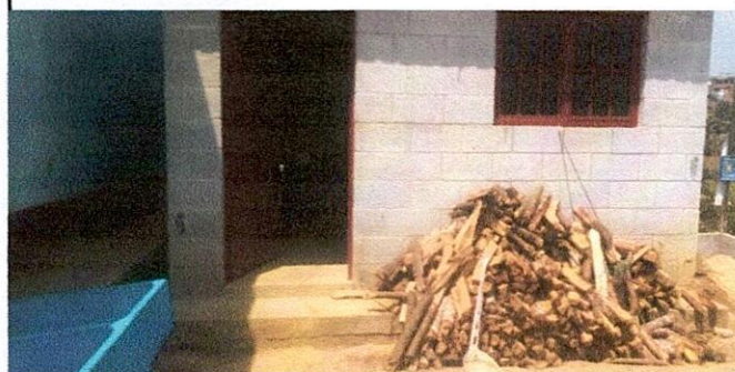
Foto 1: Cocina necesita ser remozada por poco espacio
