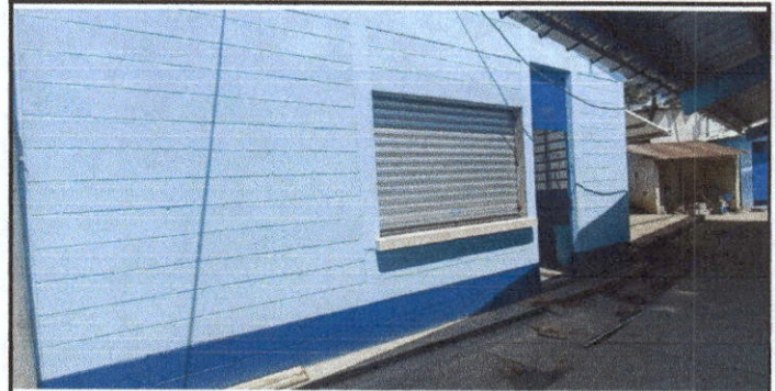
foto 12: pintura, persiana y cornisa en cocina.
