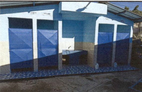
foto 5: piso, azulejo y pintura en sanitarios exteriores
