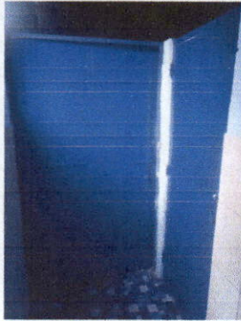
foto 1: pintura en puertas de baños
