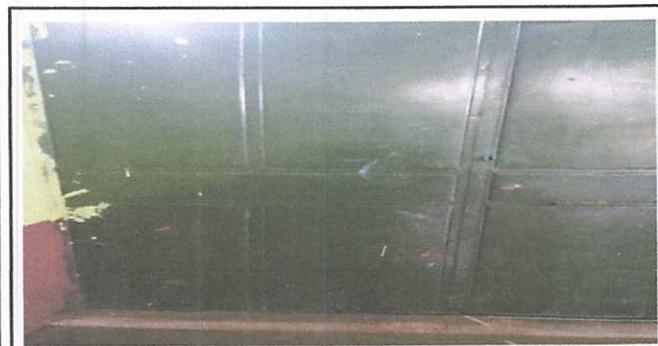
Foto 5: mantenimiento en puertas del establecimiento
