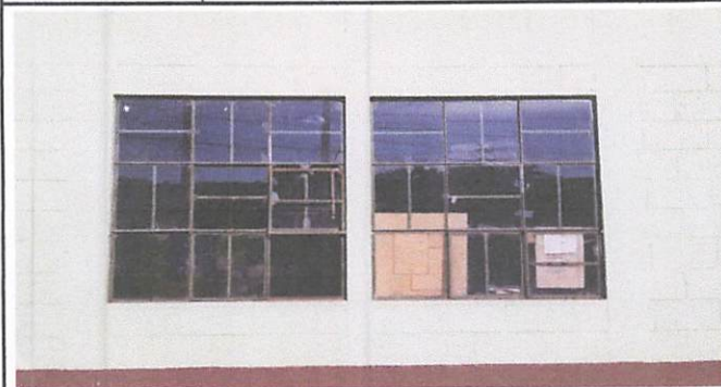
Foto1: se necesita colocar balcones
