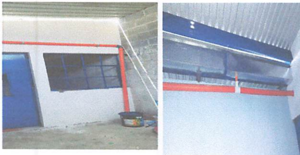
Foto 3: bajada de agua y canales en dirección y bodega
