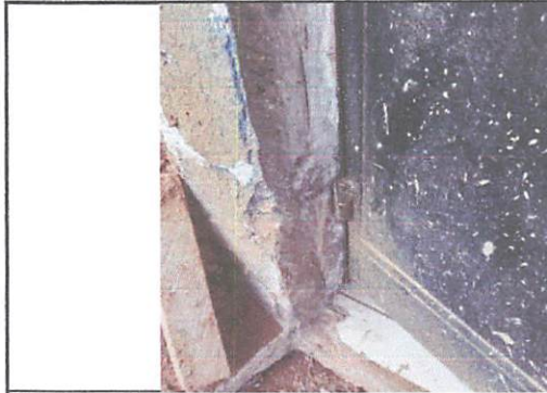
Foto 2: Puertas de sanitarios Deterioradas
