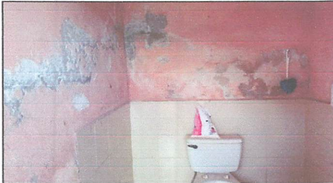
Foto 1: Paredes y tasas de sanitarios deterioradas
