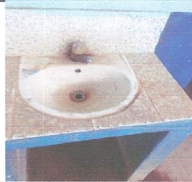
Foto 4: Lavamanos en malas condiciones
