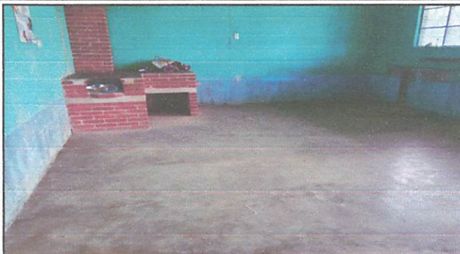
Foto 2: filtraciones de humedad en la parte inferior.
