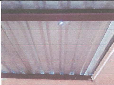
Foto 3: Techado en mal estado
