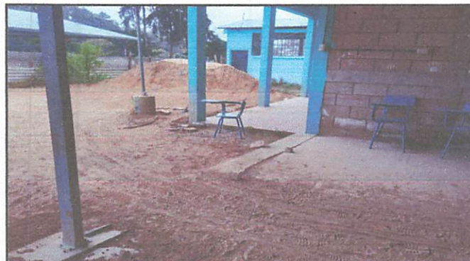
Foto 3: Pasillo de comedor con filtración de tierra
