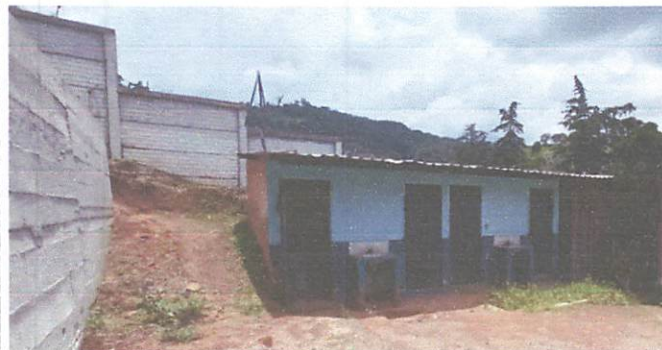
Foto 5: Tierra en exceso sobre las paredes de los sanitarios .
