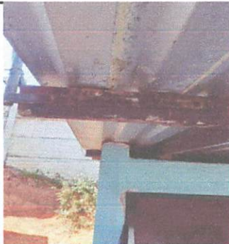
Foto 5: Costaneras de techado oxidadas.
