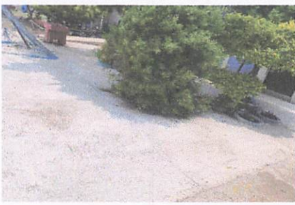
Foto 5: Cementado con desnivel
