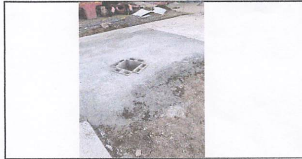
Foto 6: Cementado con desnivel, canales y bajadas
