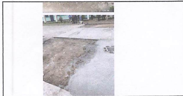
Foto 5: Cementado con desnivel
