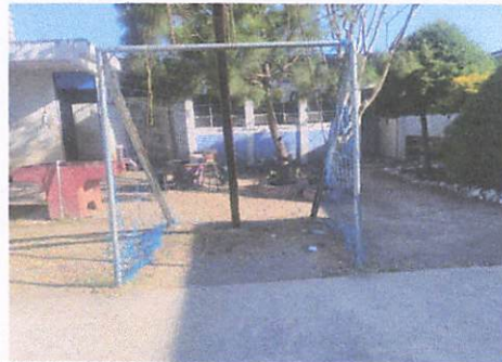
Foto 6: Cementado con desnivel, canales y bajadas
