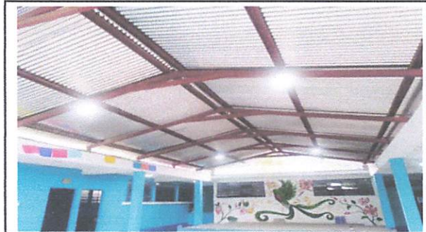
Foto 2 ENERGIA ELECTRICA EN SALON DE USOS MULTIPLOS
