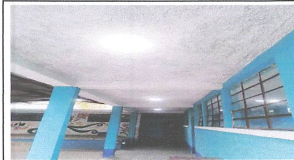
Foto 1: ENERGIA ELECTRICA CORREDOR
