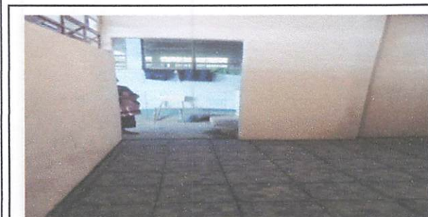
Foto 5: REPELLO, CERNIDO Y PISO CERAMICO EN COCINA
