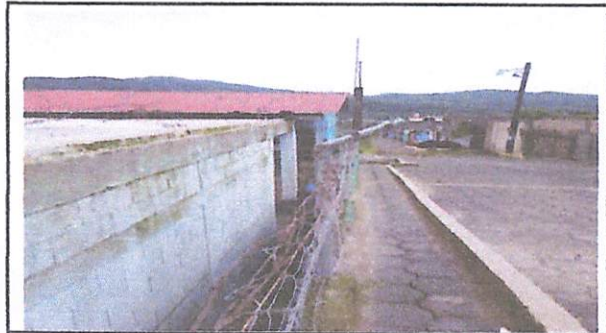
Foto 2: QUITAR ALAMBRE Y COLOCAR ALAMBRE DE PUAS
