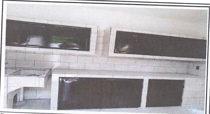
Foto 2: colocación de gabinete y aéreo para colocar trastes de cocina, aéreo de cemento con puertas de metal pintadas color madera
