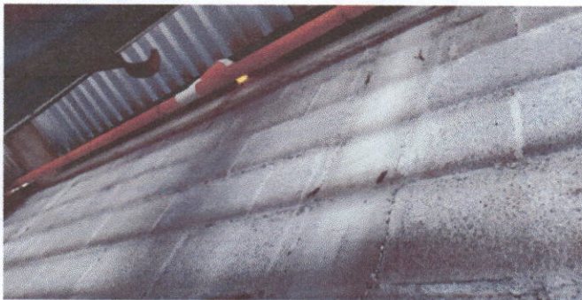
FOTO DESPUES A LA ELABORACION Y COLOCACION DE CANALES Y BAJADAS DE AGUA PLUVIALES
