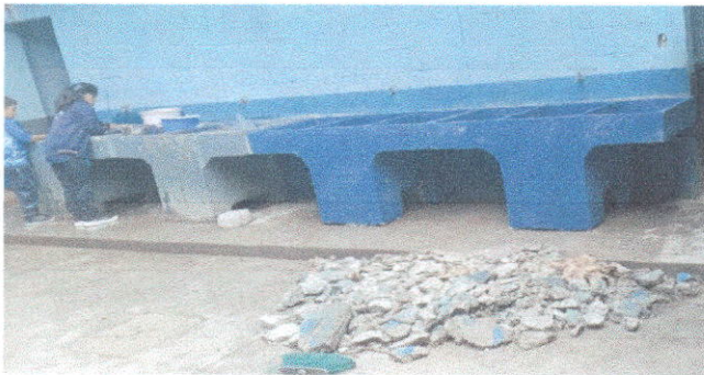
Foto 5: CAMBIO DE PILAS
