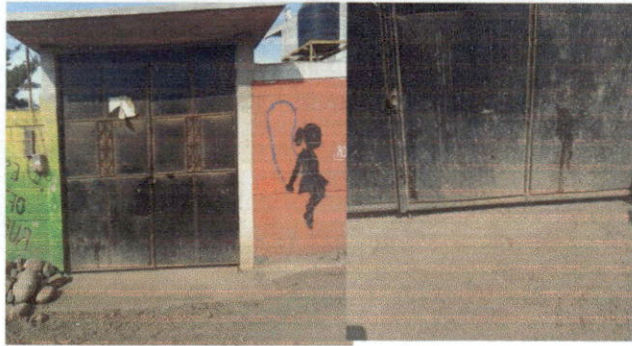
Foto 1: ÁREA DE ENTRADA, PORTÓN DETERIORADO POR LLUVIA PLUVIAL, MANTENIMIENTO EN MURO PERIMETRADO
