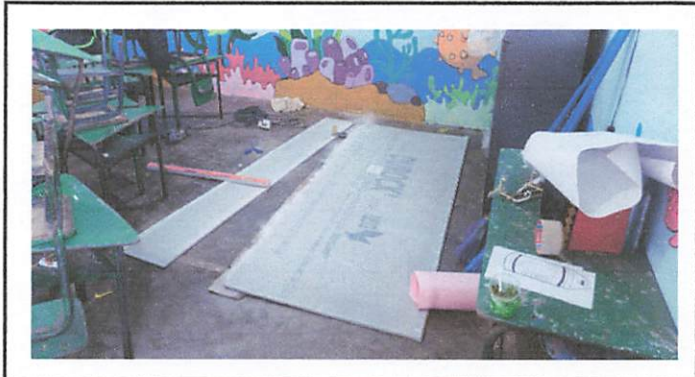
Foto 2: Reglon 1 tapado entre costanera y pared
