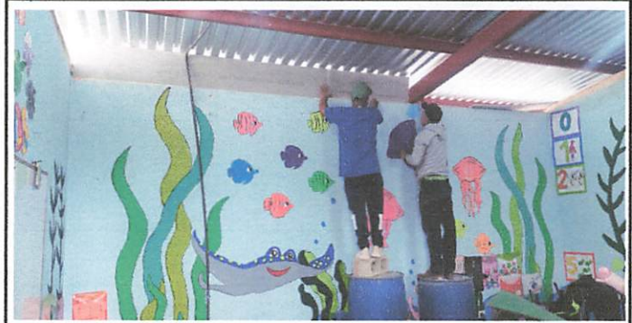
Foto 2: Reglon 1 Tapado entre costanera y pared
