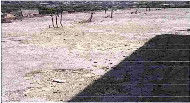
Vista actual de la losa donde se esta desprendiendo y a tapado bajadas de agua
