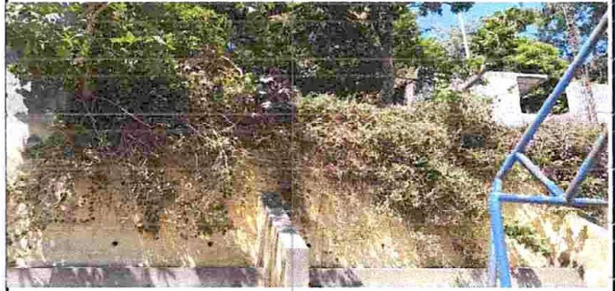
Vista de la pared que es necdesario dar continuidad por el deslizamiento de tierra y el agua pluvial.
