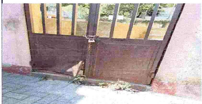
Vista de la puerta que da acceso a entrada a la cancha y esta deteriorada por el deslissamiento de agua con tierra, necesita compostura y chapa nueva.
