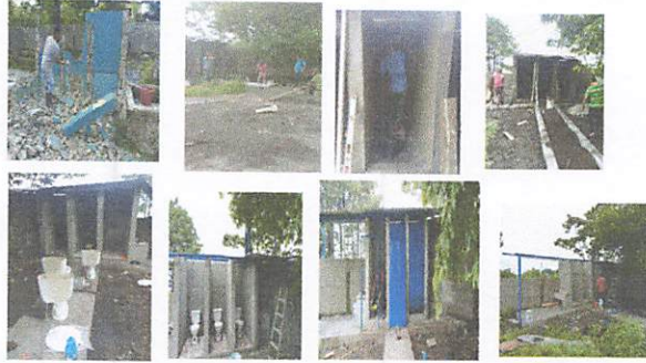
Foto7: movilización de sanitarios por mala ubicación en el patio
