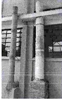
Foto 7: COLOCACIÓN DE CHIMENEAS PARA EVITAR QUE EL HUMO INGRESE A LAS AULAS Y AREA DE JUEGOS
