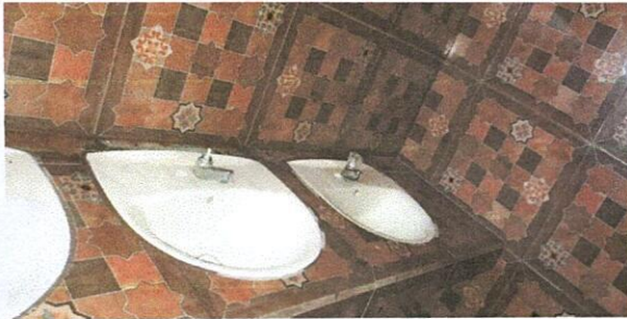
Foto 5: los lavamanos se encuentran en mal estado
