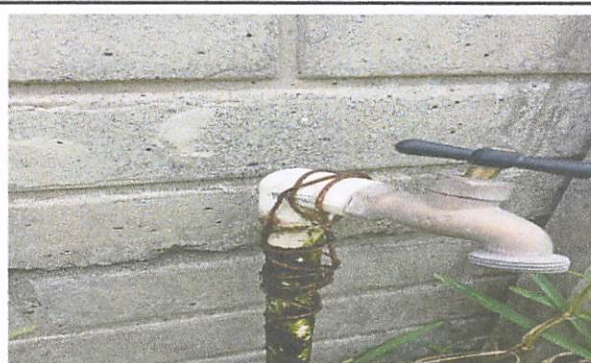
Foto 4: Chorros en mal estado.
