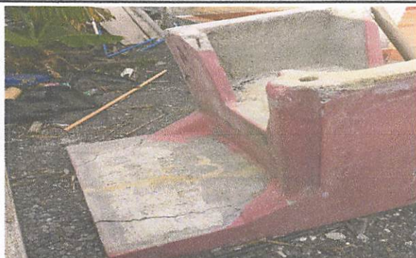
Foto 3: pila en mal estado
