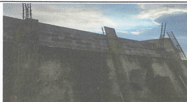
Foto 5: Construccion en mal estado
