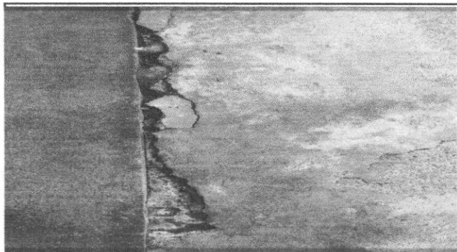
Vista del antes del corredor, con muchas grietas y poco atractivo
