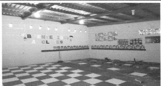
En esta fotografía se evidencia los trabajos que se realizan en las aulas por deterioro del piso
