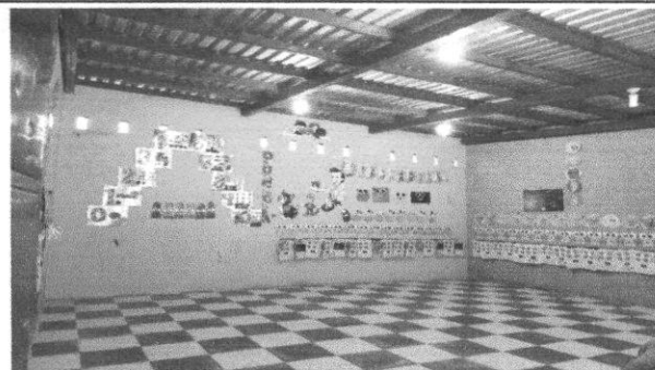
una vez terminada la puesta del piso ceramico antideslizante se aprecia otra panoramica
