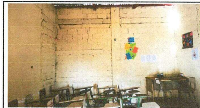
Foto 4: salones con pintura deteriorada
