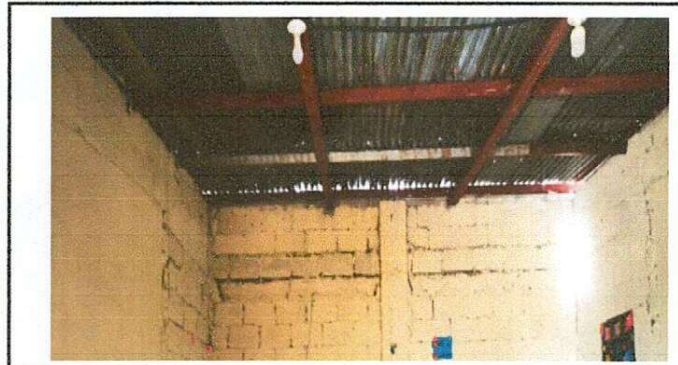
Foto 1: Lámina en malas condiciones
