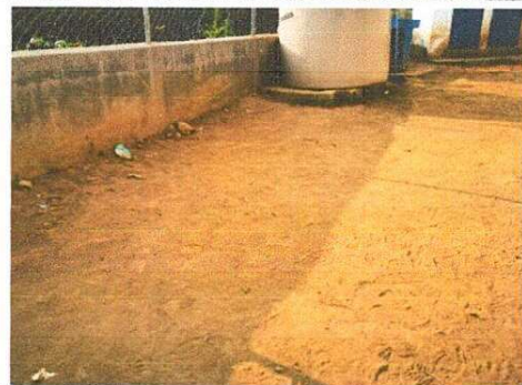
Foto 6: patio sin pavimentación
