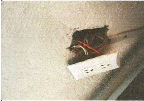
Foto 1: tomacoorientes en malas condiciones
