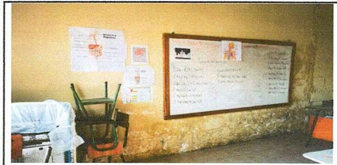
Foto 3: Salon con humedad
