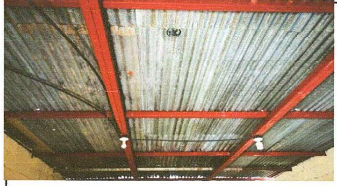
Foto: Lámina en malas condiciones
