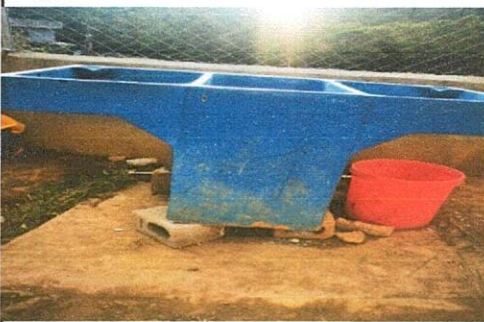
Foto 5: pila en malas condiciones
