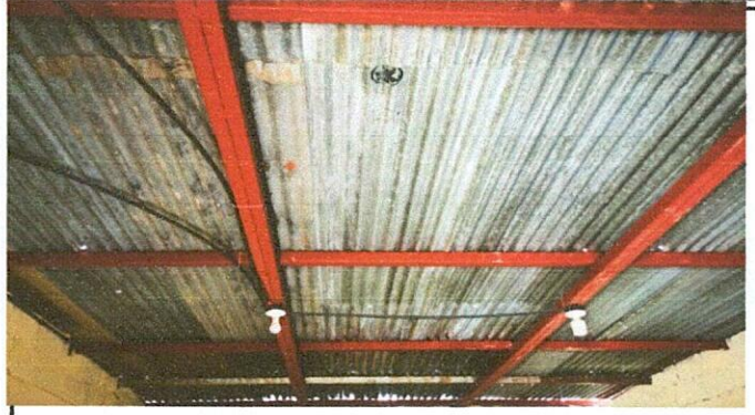
Foto: Lámina en malas condiciones
