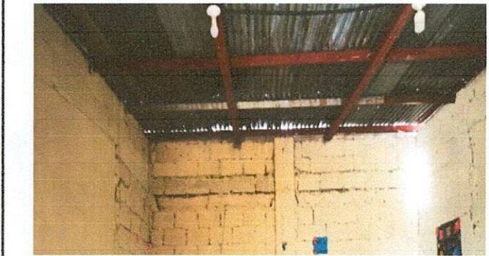
Foto 1: Lámina en malas condiciones
