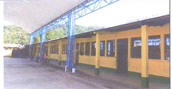
Fotografía de culminación de bajadas pluviales y techado de la planta baja. 06/05/2024
