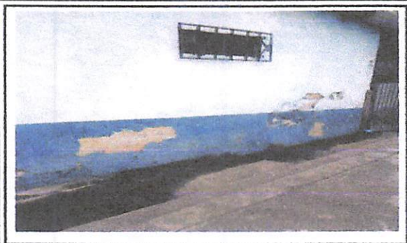
PARED EN MAL ESTADO
