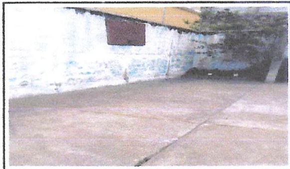
PINTURA EN MAL ESTADO
