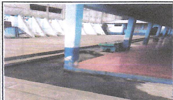
PINTURA EN MAL ESTADO
