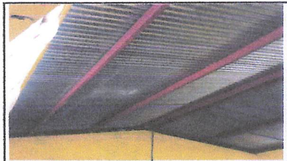
TECHO EN MAL ESTADO
