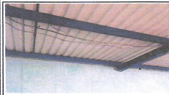
INSTALACION ELECTRICA EN MAL ESTADO
