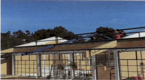
Foto 1: Trabajando en el techado (terminando de quitar la lámina en mal estado).
