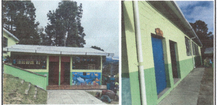
Foto 2: sustitución de canal de tubo pvc por canal alumizinc Sustitución de tubos de bajada por deterioro.
