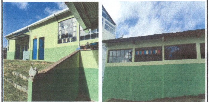
Foto 4: Pintura en interior y exterior por desgaste.
