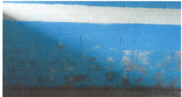
Foto 4: Pintura en interior y exterior por desgaste.
