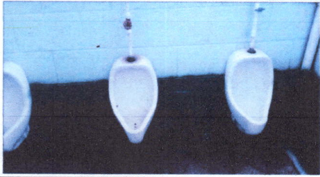
Mingitorios sanitarios de maestros
