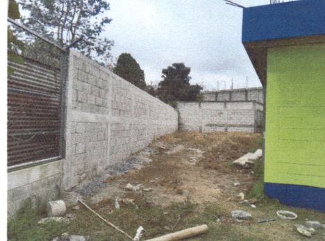
Foto 2: Muro perimetral finalizado, el cual fue recibido con satisfacción por el Consejo Educativo
