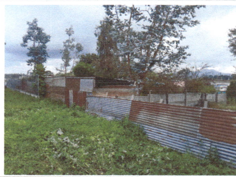
Foto 2: Vista de otro extremo donde se requiere la construcción de muro perimetral
