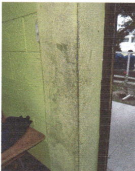
Foto 5: deterioro de la pintura actual de los salones de clases
