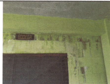
Foto 6: se requiere impermeabilizar dos salones de clases.
