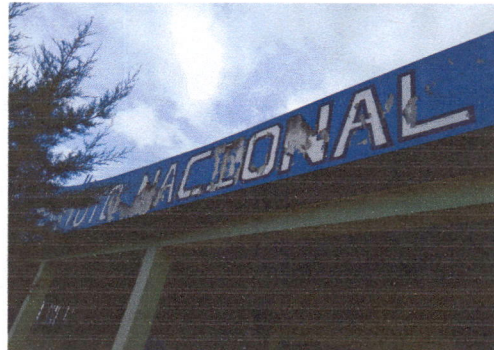
Foto 4: deterioro de la pintura actual del edificio escolar
