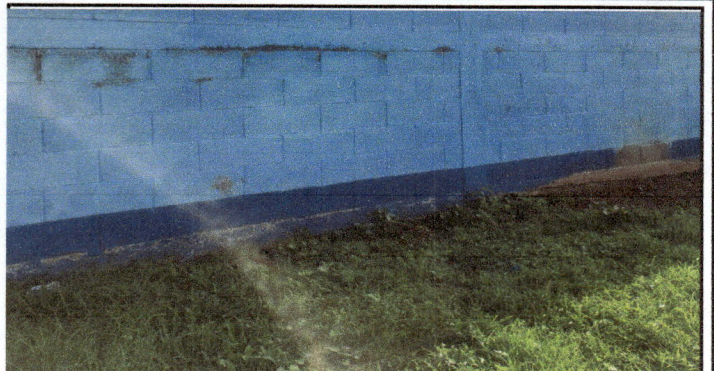
Foto 2: Deterioro de la pintura de las paredes que circulan el salón de clases
