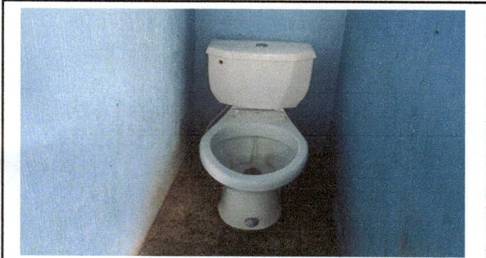
Foto 3: Pintura en malas condiciones por la humedad del agua
