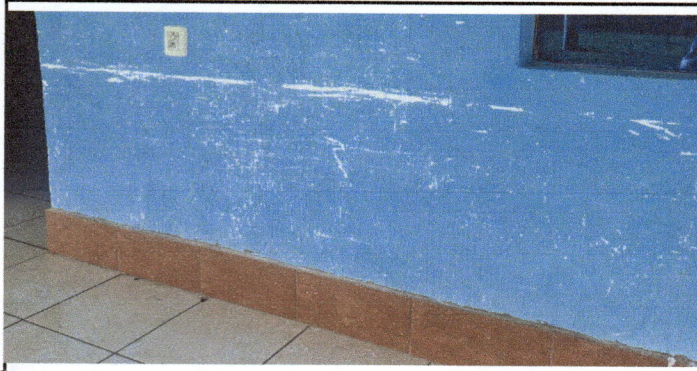
Foto 1: Paredes de los salones de clase que se pintaron hace 5 años
