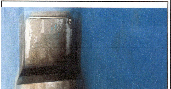
Foto 4: Desgaste del miguitorio de los baños de los niños
