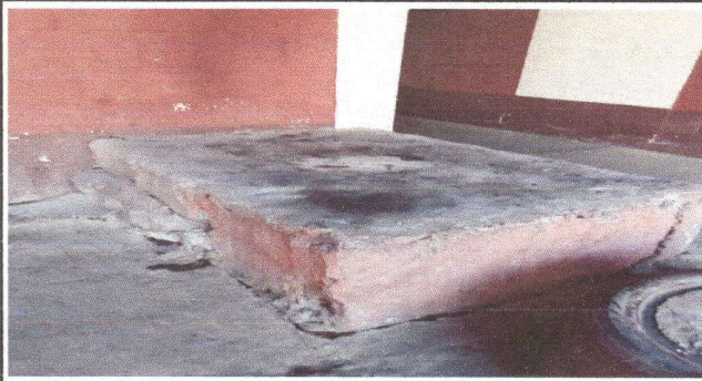
USO PROVISIONAL PARA COSINAR ACTUALMENTE EN EL ESTABLECIMIENTO.
