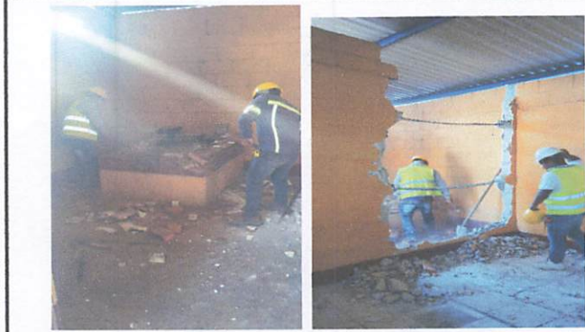
FOTO 1: Ampliación y construcción de dos planchas de cocina, lavastrastos, mesa de concreto y piso cerámico.
